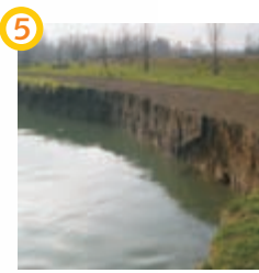
Erosion de berge
